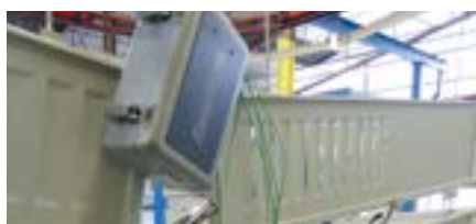
CONTRÔLE TEMPÉRATURE FOUR
